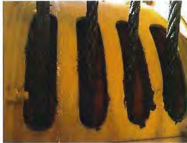
e. Elevada corrosión en pestaña de poleas de cables de acero
